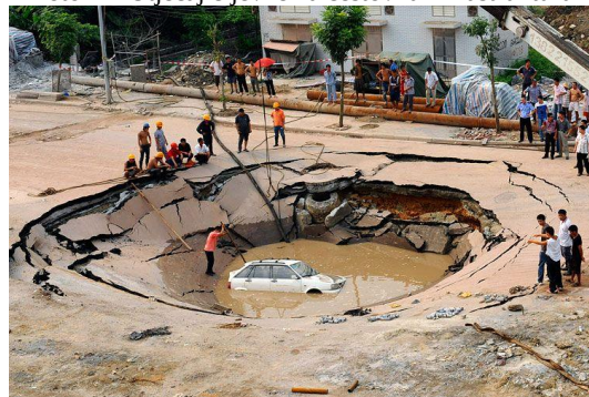
Foto 1 – Utjecaj cijevne na cestovnu infrastrukturu
