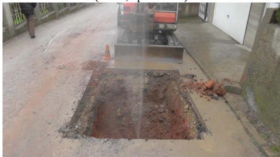
Foto 7 – Detektovano curenje ispod saobraćajnice (Tuzla, april 2013.)
