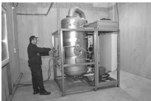
Slika 5. Postrojenje za otpadne vode [4]
