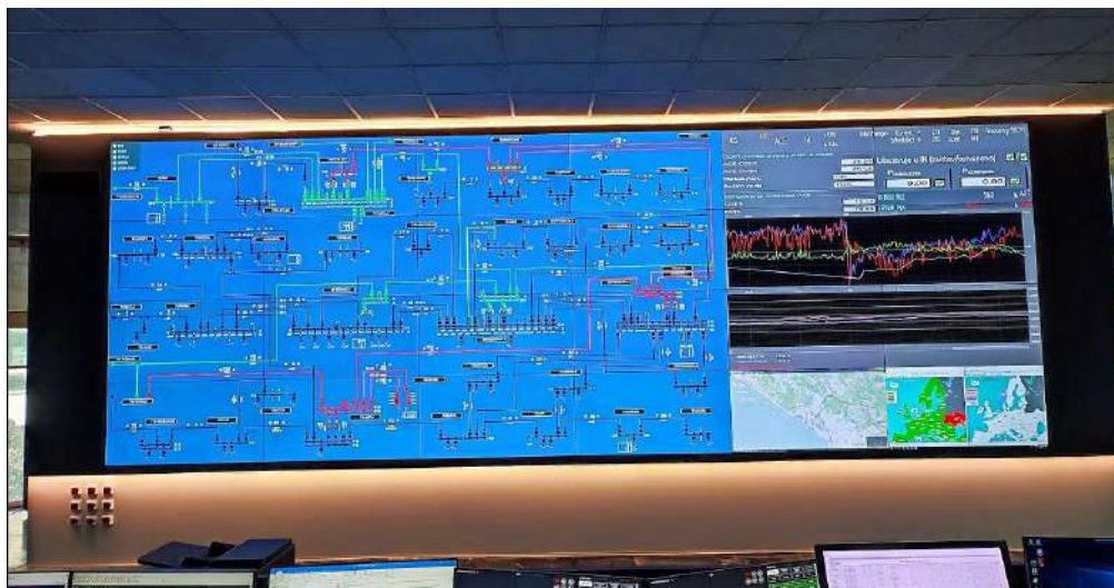
Slika 2. SCADA sistem u Nacionalnom dispečerskom centru – Crnogorski elektroprijenosni sistem (CGES)
