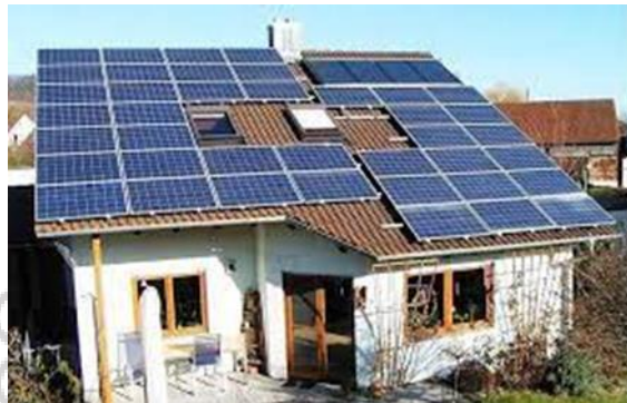
Slika .6. Solarni paneli na kući
