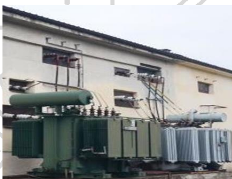
Slika 1. Fotografski prikaz energetskih transformatora u sklopu pripadajuće trafostanice
