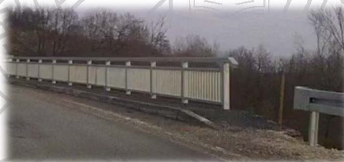
Slika 4. Praznina između zaštitne ograde i otvorenog završetka ČOO
