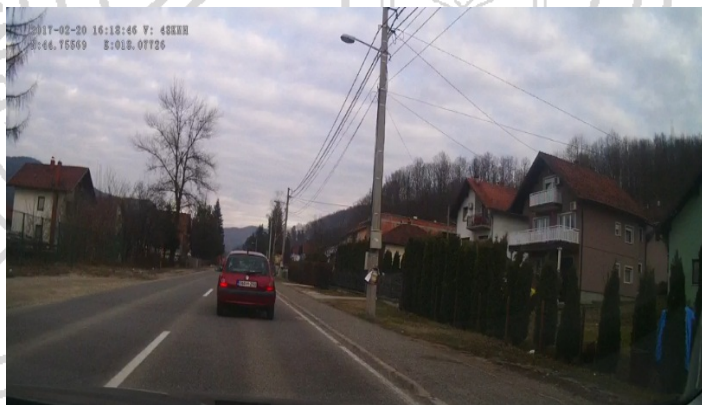
Slika 2. Neadekvatno štićeni stubovi elektrodistribucije i javne rasvjete
